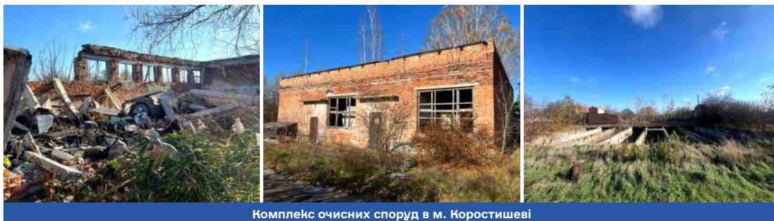
Комплекс очисних споруд в м. Коростишеві
